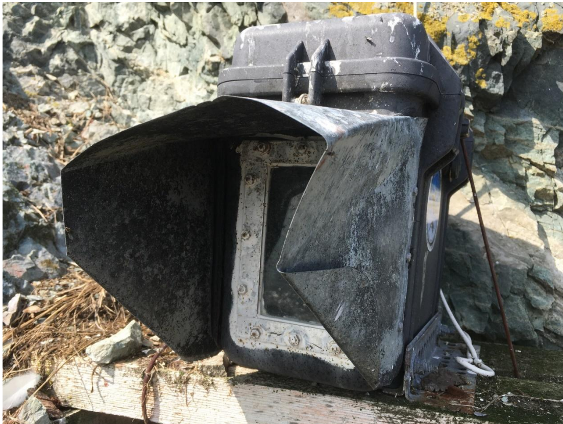
Рис.3. Внешний вид регистратора № 2 до обслуживания. Защищавшая стекло бленда согнута от напора ветра. Была демонтирована.
